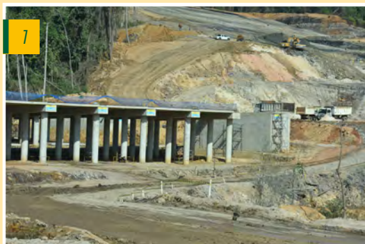
Výstavba dálnice vedoucí k novému hlavnímu městu Indonésie zdevastovala velkou část pobřeží Balikpapanského zálivu.
